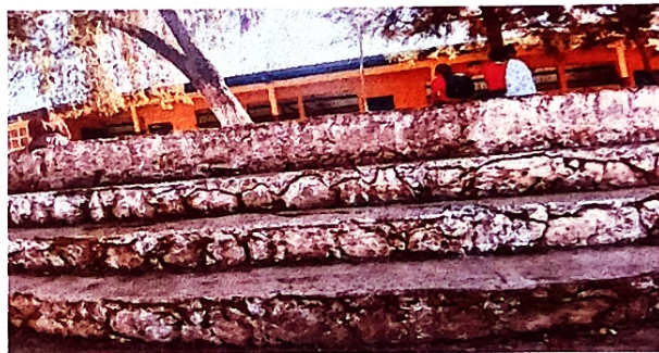
Foto 4: Se observa que en este ambiente se encuentra sin techo.
